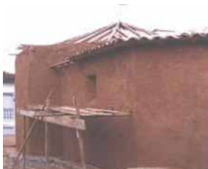
Figura 4: Conclusão dos serviços de revestimento de terra: chapisco, emboço e reboco: Técnicas Tradicionais Fonte: Acervo IEPHA/MG, s.n.
