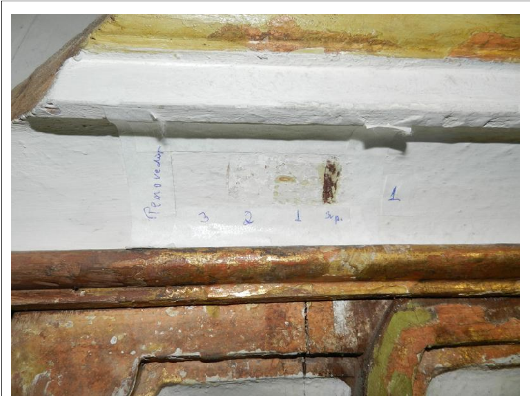
Foto 04: Prospecção 1: A camada 1 (base de preparação) encontra-se coberta por resquícios de tinta branca, não removidos porque o uso do solvente pastoso solubilizou a base, levando esta a se desprender com a camada anterior. Foto: IEPHA/MG, 10/07/2020.
